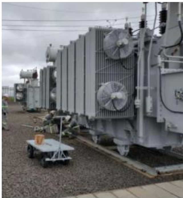
Figura 5 - Inspeção TR5 Subestação
